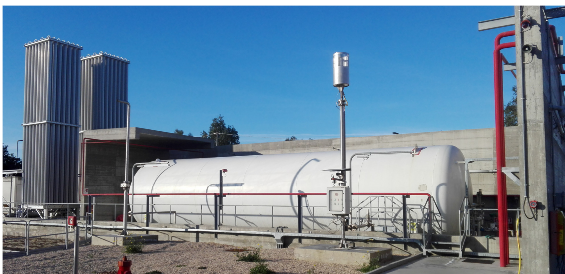
Figura 3.8 - Impianto GNL coop. 3A Arborea.
