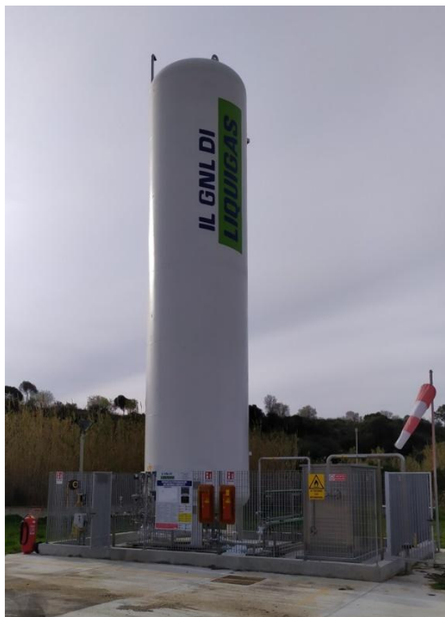
Figura 3.9 - Impianto GNL Liquigas stabilimento Argiolas Formaggi (Fonte: http://www.cpl.it/gnl/ ).
